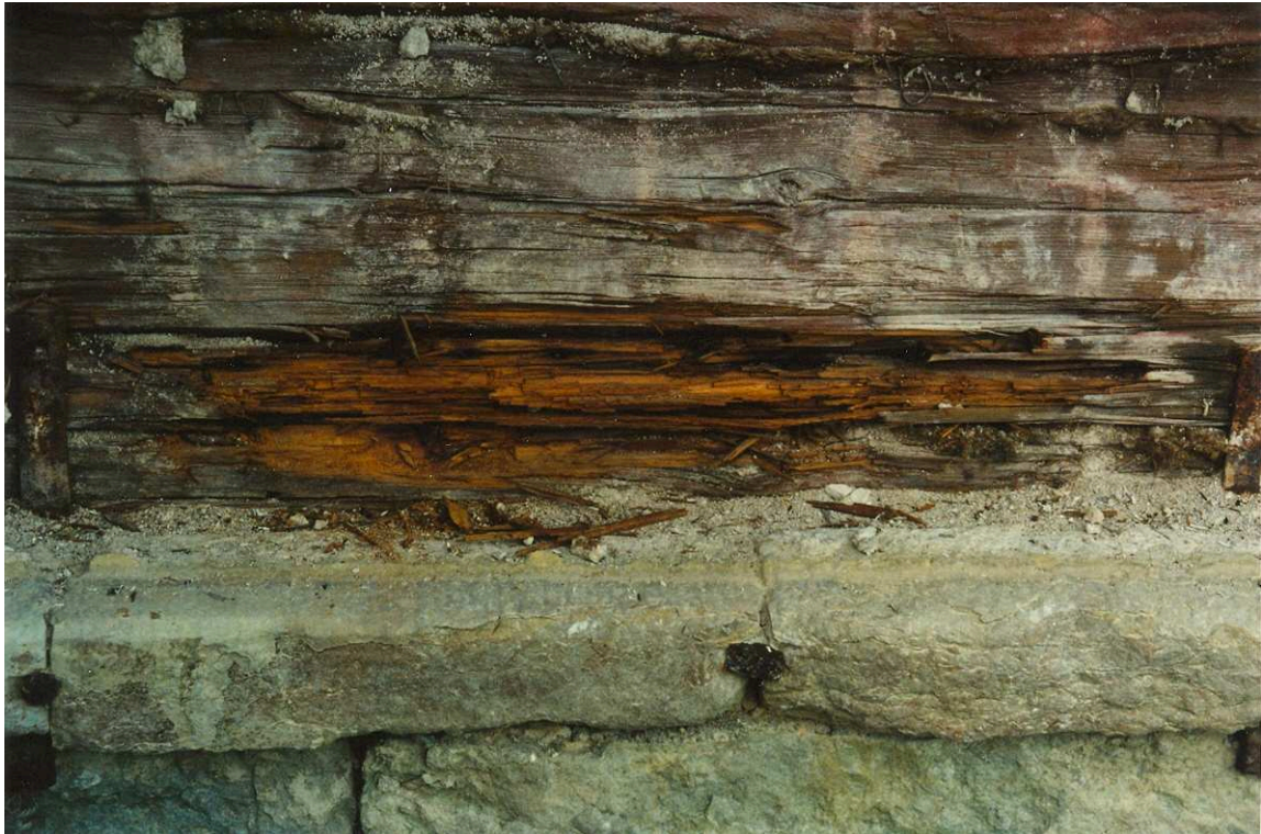
Rötskada i syllen
