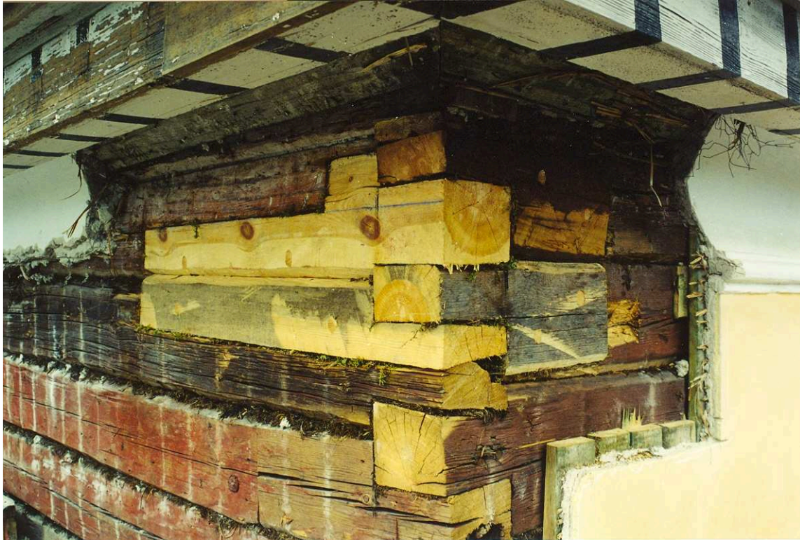
Rötskadat timmer ersatt med nytt virke i Sydöstra hörnet av östra paviljongen. Film nr. 2548
