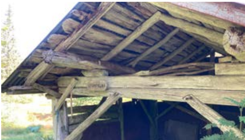
Stumpelóa ved Mydland aust for Snartemo i Lyngdalen har grindbygd reisverk. Teknikken er gammal og blei brukt frå vestre Agder til Romsdal. (Foto: Hans I. Seland)
