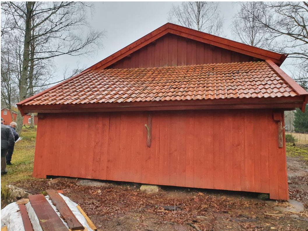
Lilla tillbyggnaden i öster efter åtgärder. Nytt taktegel, ny panel och nya vindskivor och takfotsbräda. Även logdelen fick nya vindskivor.
