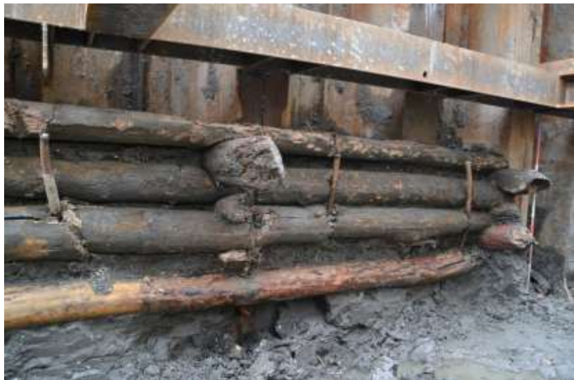
Figur 66: Løsmassestag har gjennomboret konstruksjonen. Foto NMM.
