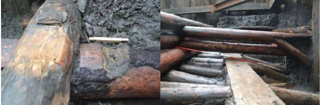
Figur 67: Til venstre skade på tømmerstokk etter løsmassestag, laftekasse K2002. Foto mot sør. Til høyre bolverk K2002. Bunnstokker og delvis vegg i konstruksjonen er trykket ned/brukket av spuntveggen. Foto mot sør. Foto NMM.
