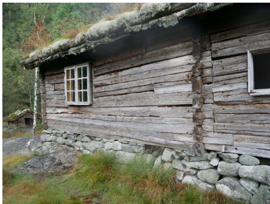
Figur 80 – Røsslistova er vurdert til tilstandsgrad 3.
