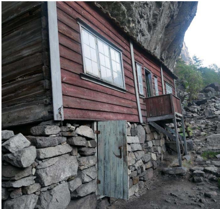
Figur 98 – Det raude Hellenen-huset er vurdert til tilstandsgrad 2.
