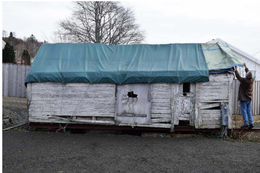
Figur 85 – Sisselastova er vurdert til tilstandsgrad 3.
