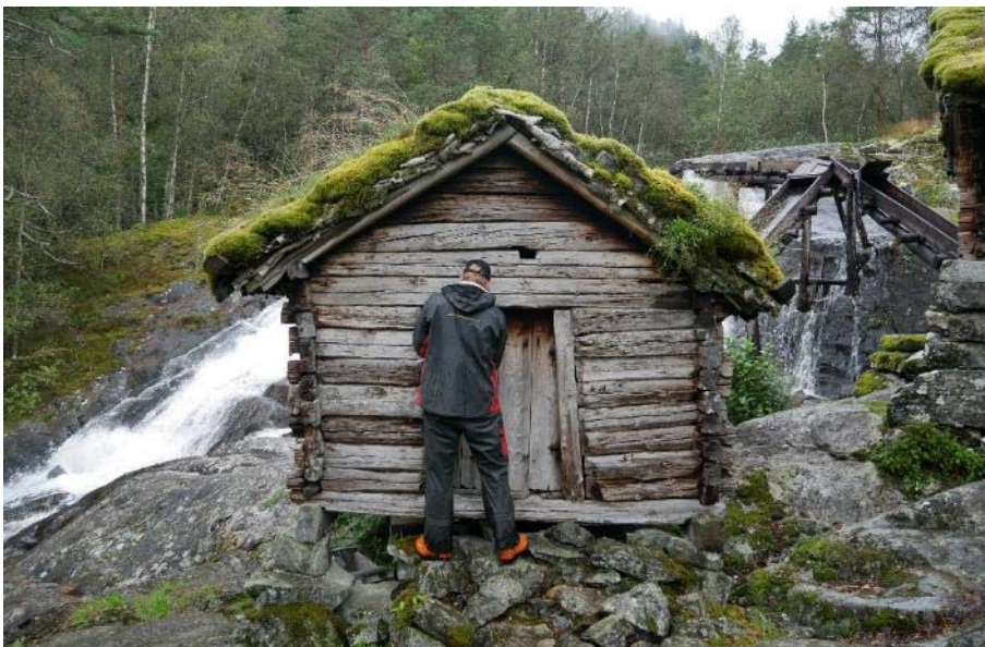
Figur 104 – Bygningane i Tveitåno ved Kolbeinstveit er nå i dårleg stand og treng vøling.
