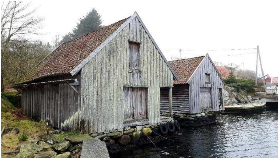
Figur 84 – Sjøhusa i Solhåla er vurderte til tilstandsgrad 2.
