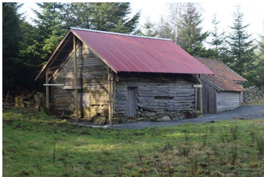
Figur 106 – Forfallet på våningshuset på Laupland (Bogn bygdemuseum) er kome langt, og det er sett inn sikringstiltak med eit provisorisk takoverbygg medan ein ventar på meir ressursar.
