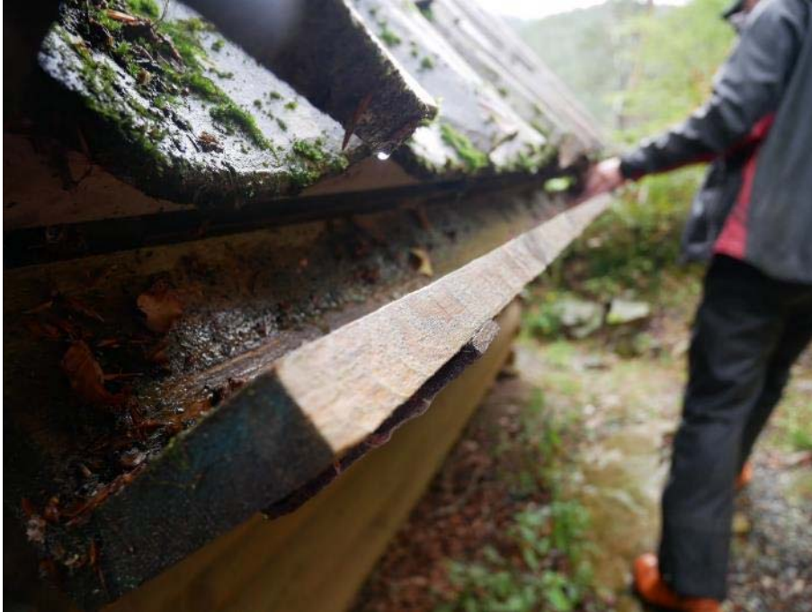
Figur 119 – Reinsking av takrenner og torvhaldsstokkar er døme på oppgåver som ein ikkje treng å vera handverkar for å gjera. Dette er enkle tiltak som har stor førebyggjande effekt, og som forlengjer levetida på utsette bygningsdelar.
