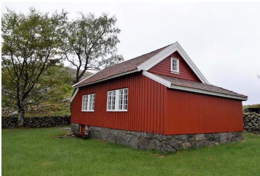
Figur 93 – Knudaheio er vurdert til tilstandsgrad 1.
