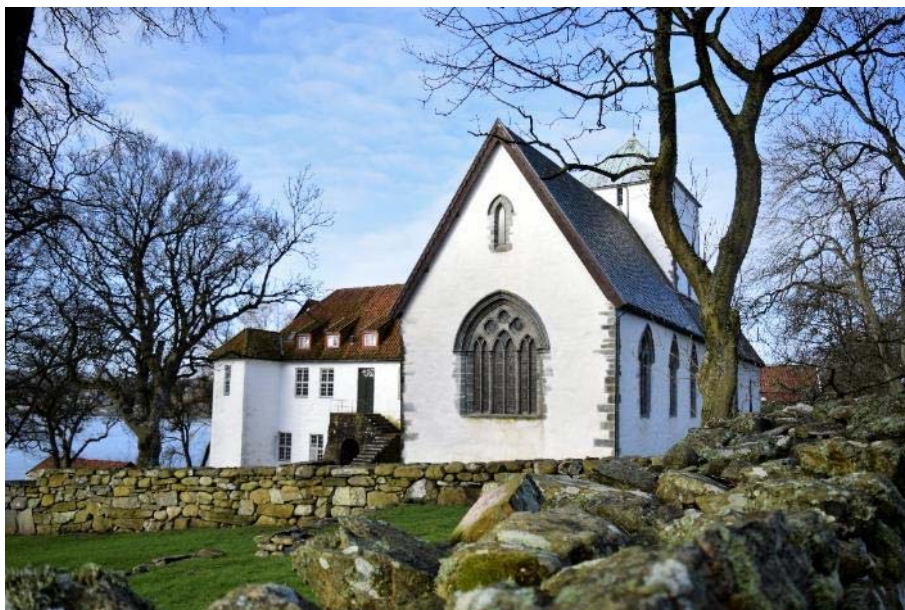
Figur 90 – Utstein kloster består av fleire bygningar/fløyer. Kyrkjefløy (nordfløya) er vurdert til tilstandsgrad 2.
