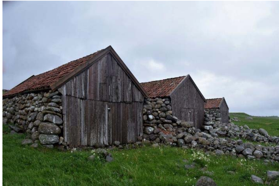
Figur 94 – Nausta på Varhaug er vurderte til tilstandsgrad 2.
