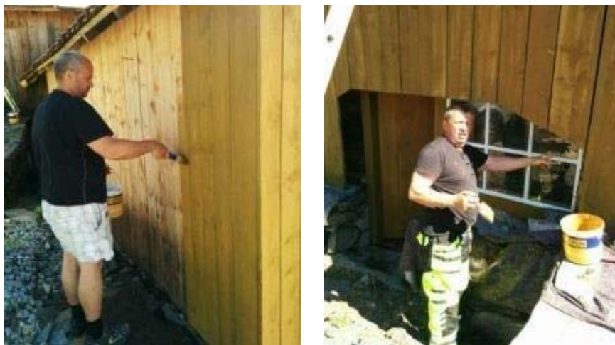
Figur 130 og figur 131 – Haugalandmuseet kokte komposisjonsmåling og måla uthusbygningane på småbruket Veien i Nedstrand. Fargeundersøkingar som blei gjorde på den gamle kledningen, viste at det hadde vore brukt nettopp komposisjonsmåling her.
