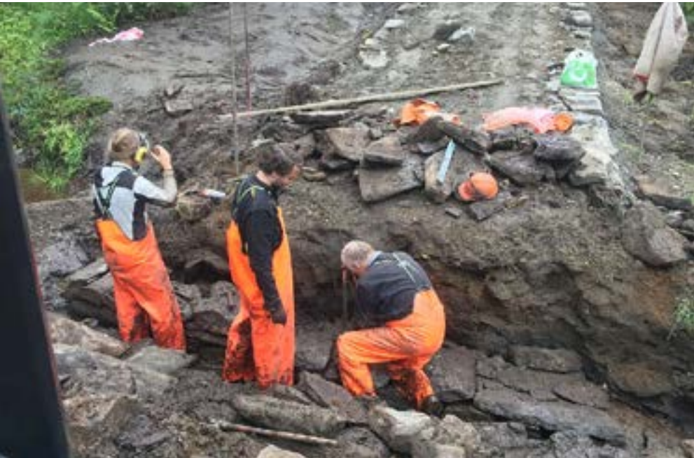
Det var liten tvil om at store delar av veita var kollapsa. (Foto: Berit Bruvik)
