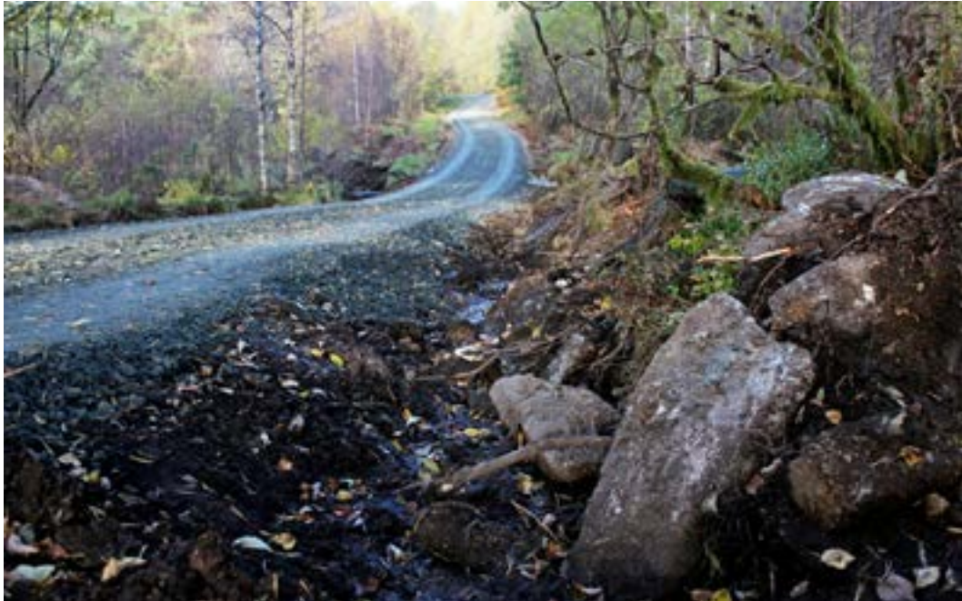
Foto teke etter «oppgraderinga» i september 2016. Ein ser til døme her at stein frå den opphavlege vegkroppen er lagt ut på sidene av vegen. (Foto: Tine Eikehaug)
