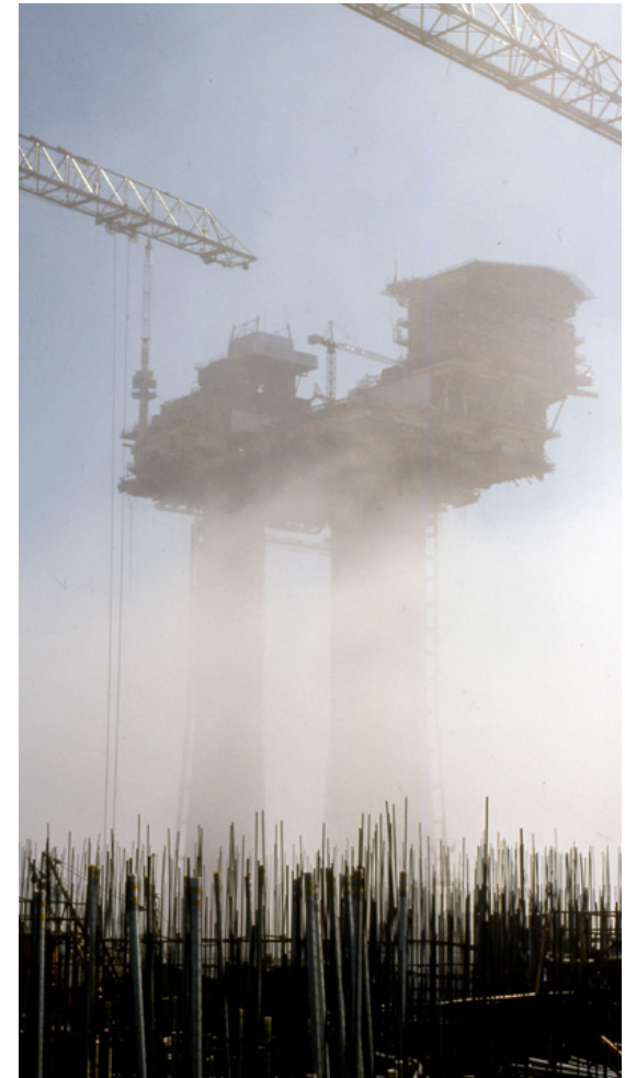
Armeringsjernet i betongunderstellet til Statfjord A. I bakgrunnen ruver Brent C i tåkedisen. Fra Jåttåvågen. Foto: Kåre Moen, Norsk oljemuseum
