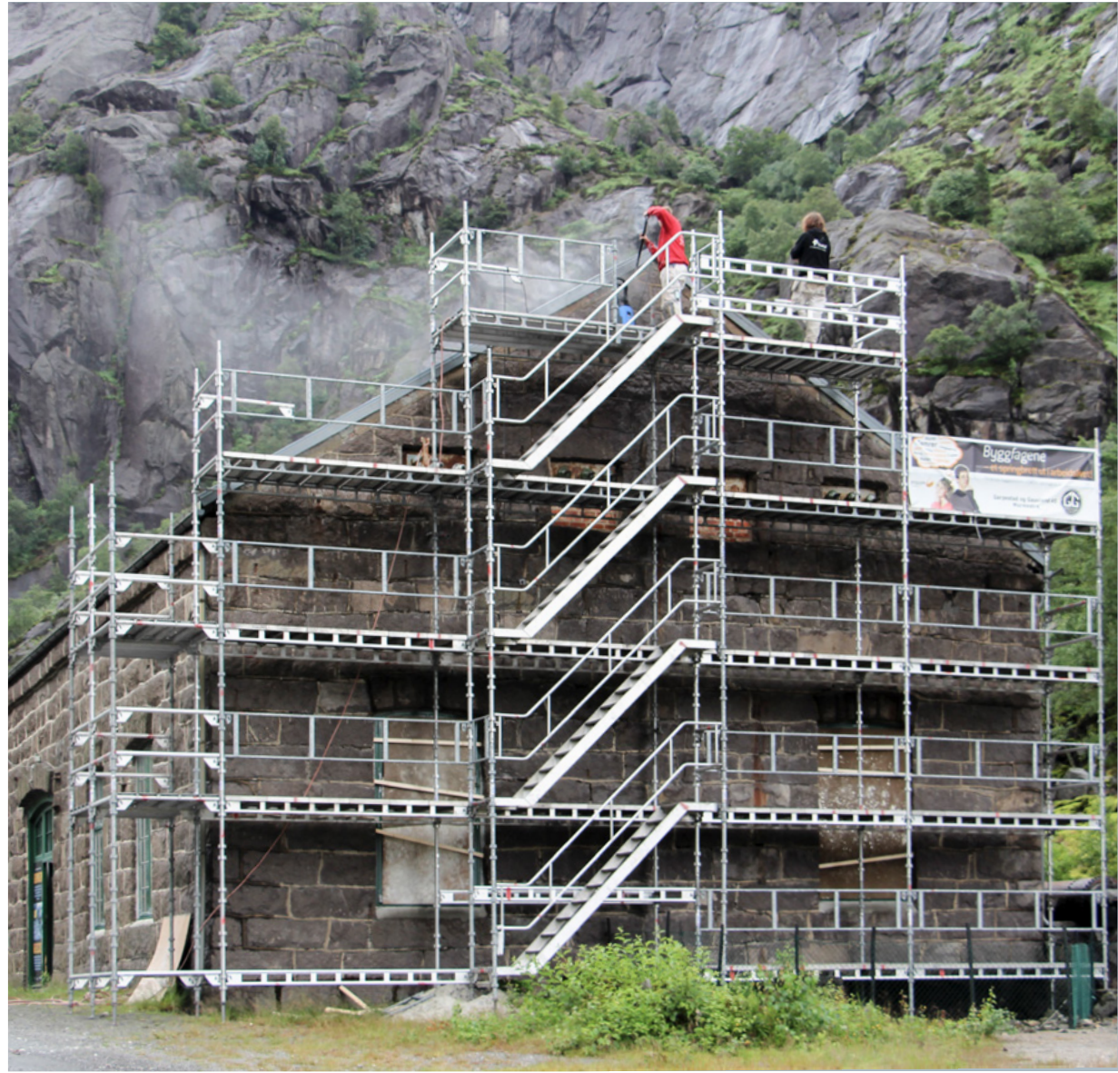
Restaurering av kraftstasjonen i Jøssingfjord. Kraftstasjonen blir en del av det nye Vitenmuseet som etter planen skal åpne i 2019. Foto: Dalane Folkemuseum
