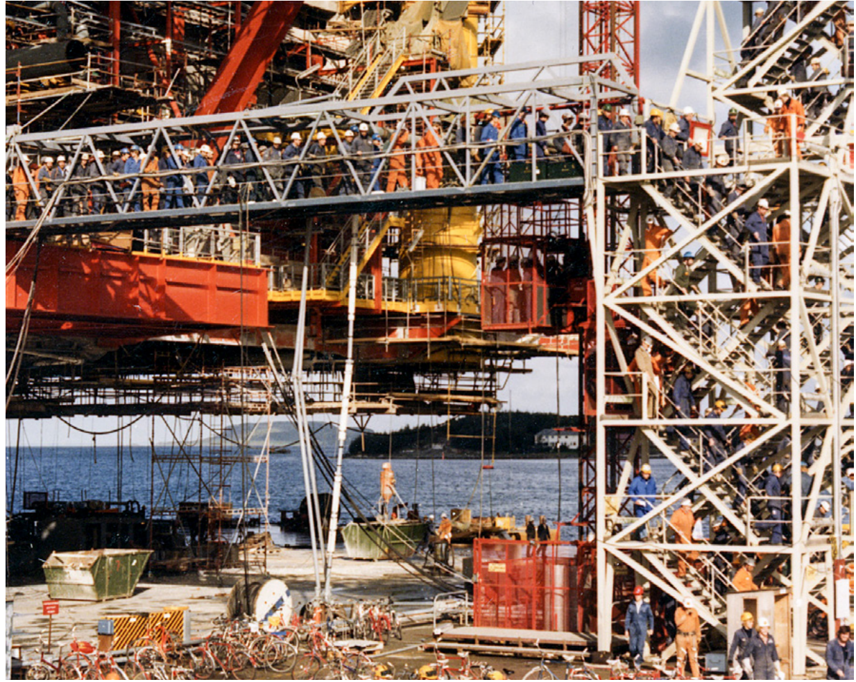
Ved ferdigstilling av dekket til Statfjord B var det mer enn 3 000 mann i arbeid på Rosenbergområdet. Dette bildet er fra et vaktskifte, hvor det ofte ble folksomt i trappene mellom etasjene. Foto: Rein Øverland, Norsk oljemuseum
