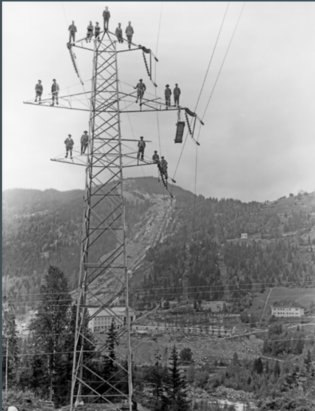
Den nye utstillingen viser blant annet dette bildet fra byggingen av Nore-anlegget i Buskerud i 1925. Mastebyggerne står nok pent oppstilt for fotografen, men ser ut til å mangle det vi i dag betegner som elementær arbeidssikring. (Foto: Ivar Aasen/Buskerud Fylkesfotoarkiv)
